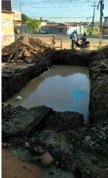
Figura 2 Rompimento da tubulação após a manutenção corretiva
